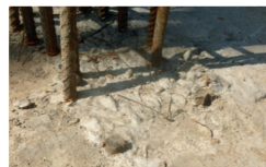
Выявлены дефекты армирования монолитных ж/б конструкций Нарушен СП 63.13330.2012 «Бетонные и железобетонные конструкции»
