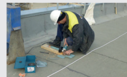
Заготовка металлических элементов производится с угрозой повреждения кровельного ковра Нарушен СП 17.13330.2011 «Кровли»
