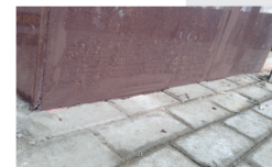
Не выполнен деформационный шов при облицовке стен здания Нарушен СП 71.13330.2011 «Изоляционные и отделочные покрытия».
