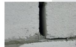
В кладке перегородок из блоков зафиксированы не заполненные швы Нарушение СП 70.13330.2012
