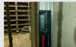
При устройстве стен лифтовой шахты зафиксированы геометрические отклонения, превышающие допустимые. Нарушен СП 70.13330.2012 «Несущие и ограждающие конструкции»
